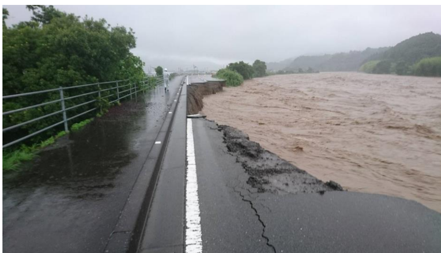
安芸川の増水で崩落した堤防と県道（平成 30 年 7 月安芸市僧津）
