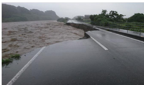
安芸川 平成30年7月豪雨災害(土居地区)
