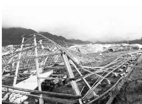
▲全壊した園芸ハウス
