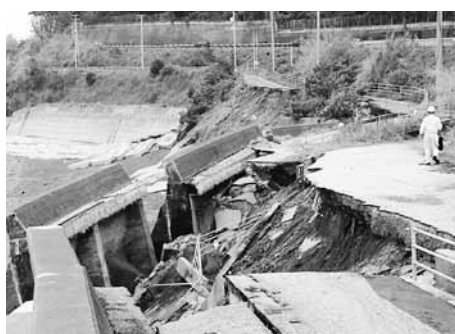
▲決壊した穴内漁港海岸の防潮堤
