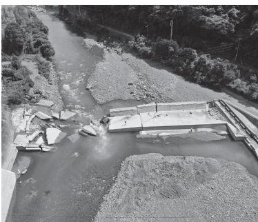
有井頭首工の被災状況
