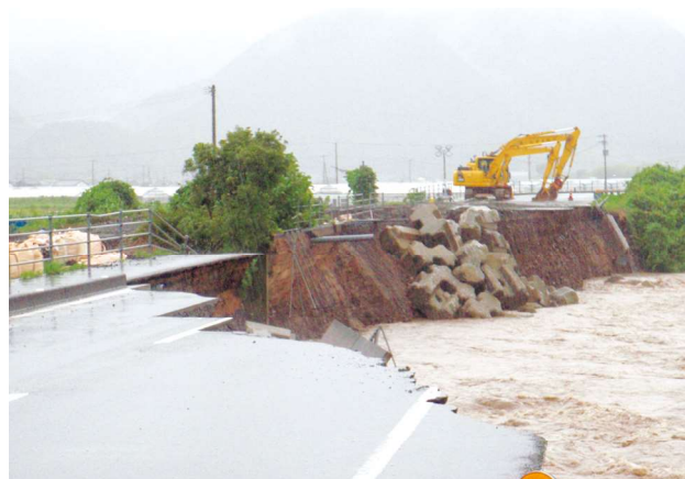
豪雨により水位が上昇し、河岸が大きく削られた
